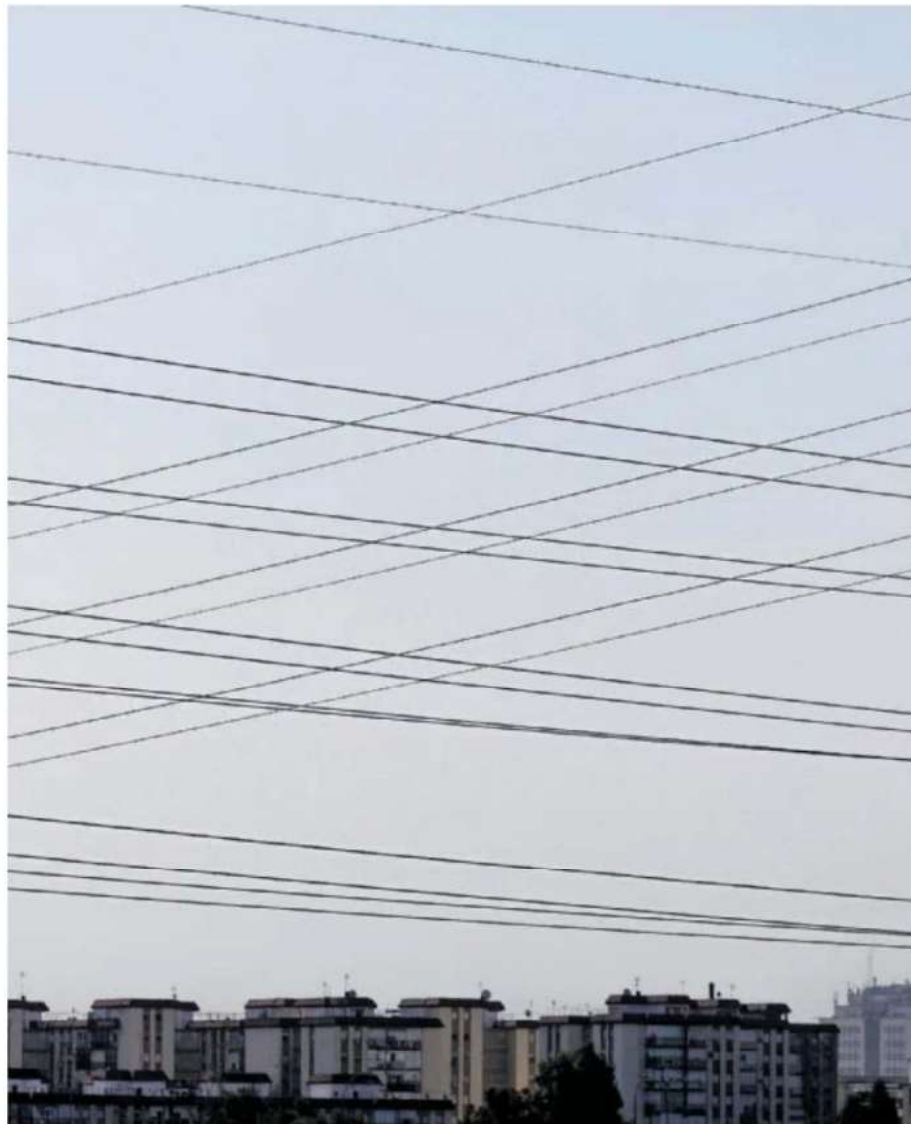
Tendido eléctrico a las afueras de Sevilla. PACO PUENTES
